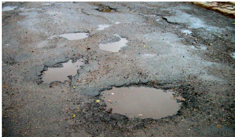
Fotografia 1 - Nawierzchnia ul. Św. Anny
