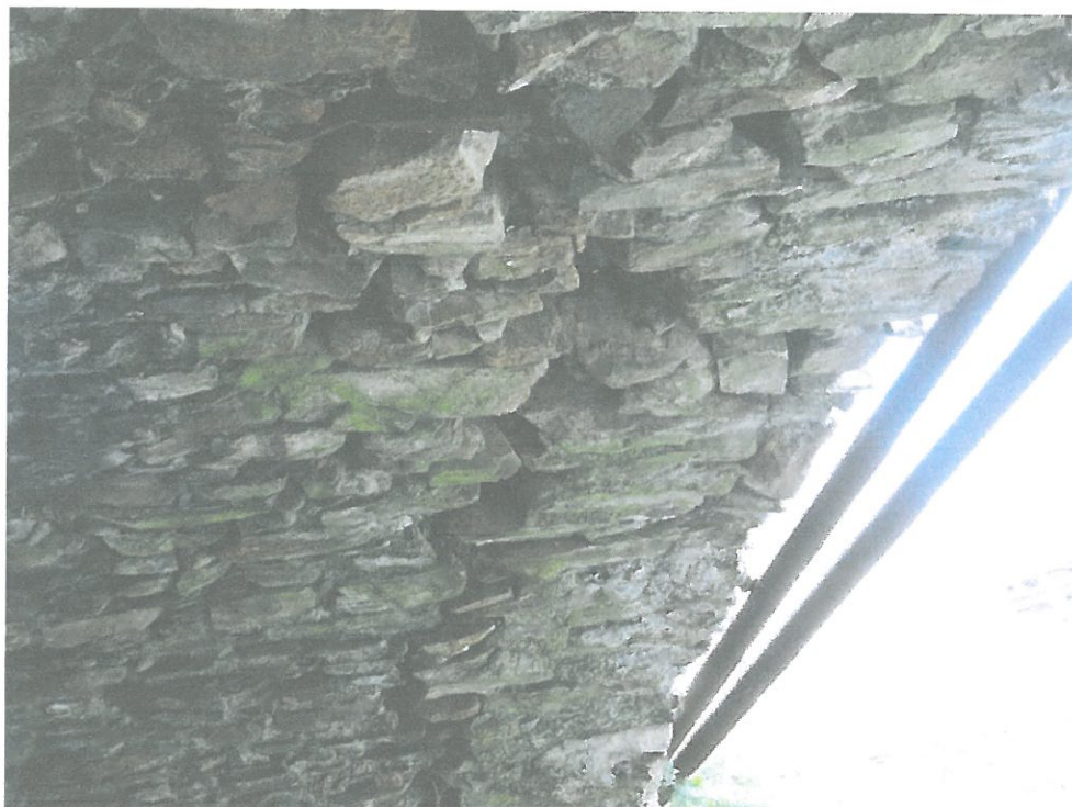
Fot. 11. Widoczna szczelina powstała przez odspojenie i przesunięcie ściany czołowej
