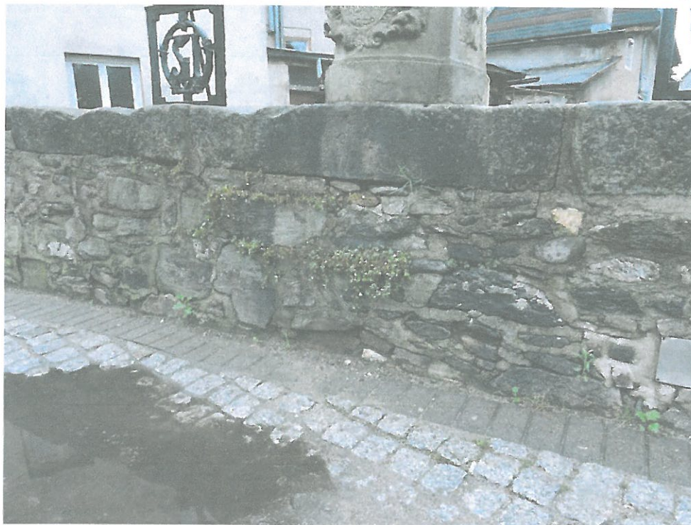
Fot. 3. Uszkodzenia spoin bariery na obiekcie, widoczna wegetacja roślin
