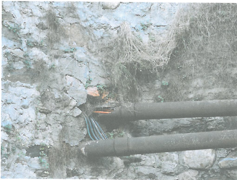
Fot. 14. Uszkodzenia rury osłonowej urządzeń obcych
