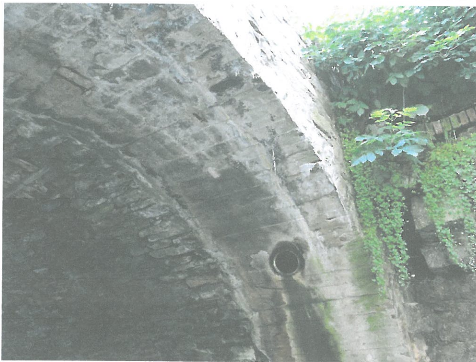
Fot. 7. Pęknięcia i osady na sklepieniu ściany czołowej. Spękania wykonanego wzmocnienia
