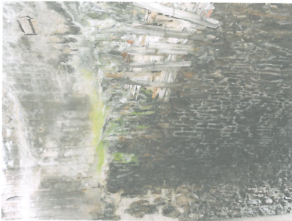
Fot. 9. Spękania i uszkodzenia konstrukcji sklepienia od strony dolnej wody
