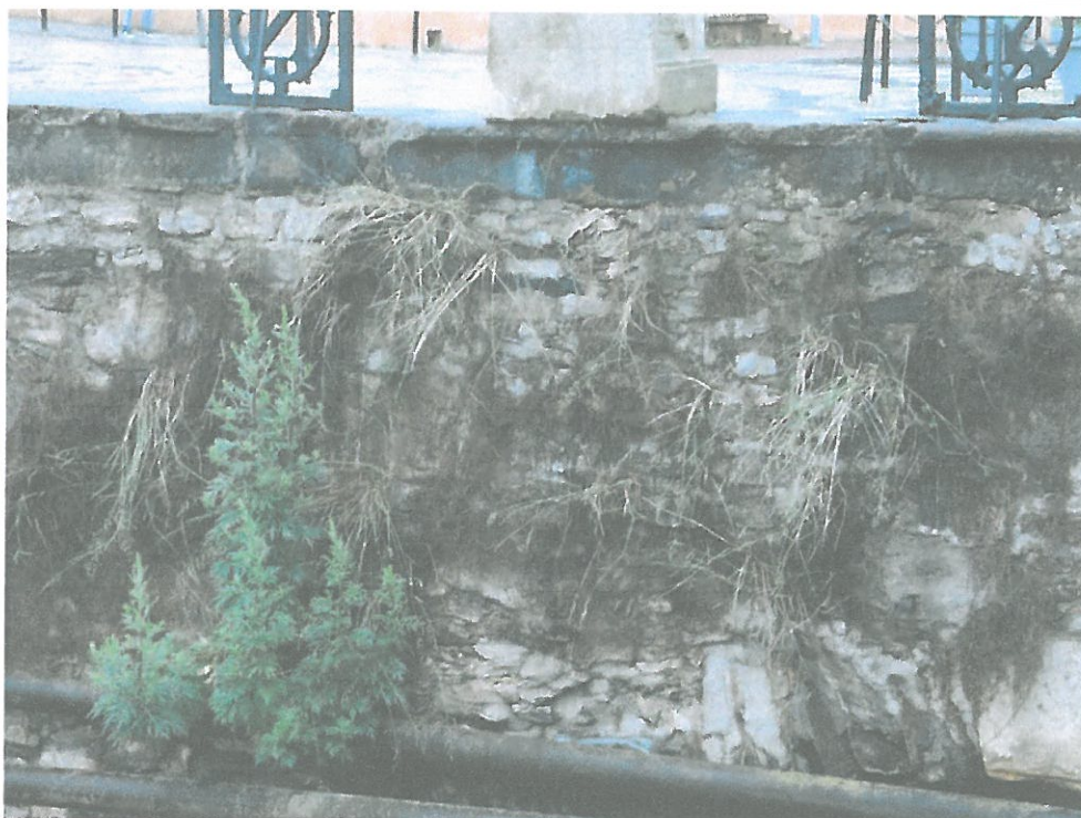
Fot. 2. Zanieczyszczenia balustrady na obiekcie w rejonie figury
