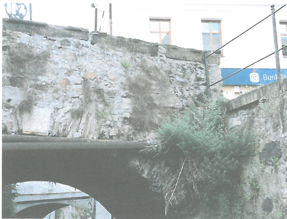
Fot. 16. Zanieczyszczenia i wegetacja roślin na murku od strony górnej wody
