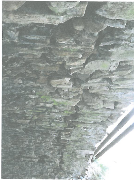
Fot. 13. Szczegół powstałej szczeliny w sklepieniu
