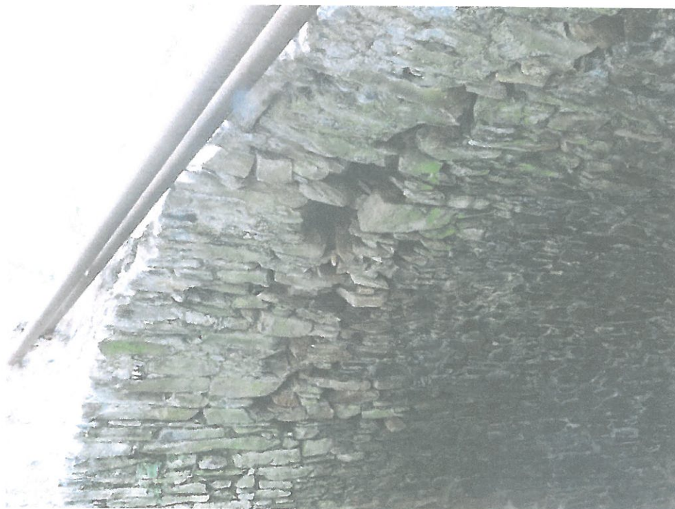
Fot. 12. Ubytki w konstrukcji nośnej i szczelina sklepienia od strony górnej wody
