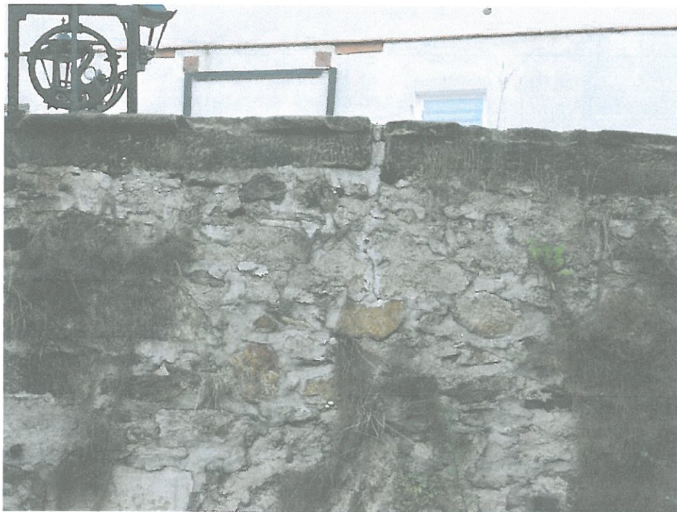
Fot. 15. Ubytki i uszkodzenia szczelin murku od strony górnej wody
