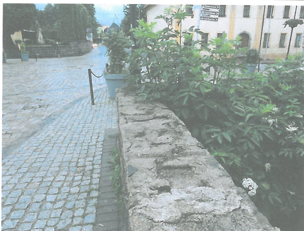
Fot. 6. Uszkodzenia nawierzchni murku pełniącego funkcję bariery
