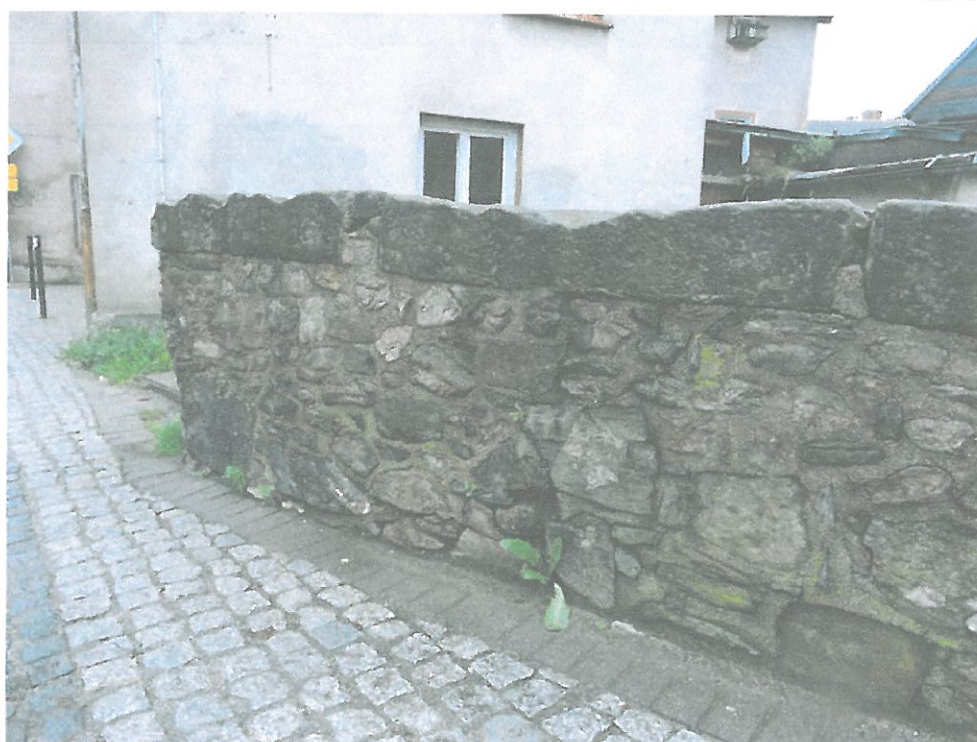
Fot. 4. Lokalne uszkodzenia spoin bariery na obiekcie
