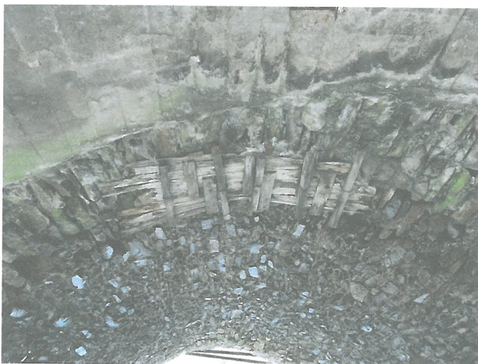
Fot. 8. Widoczne tymczasowe wzmocnienia sklepienia oraz ubytki w konstrukcji nośnej
