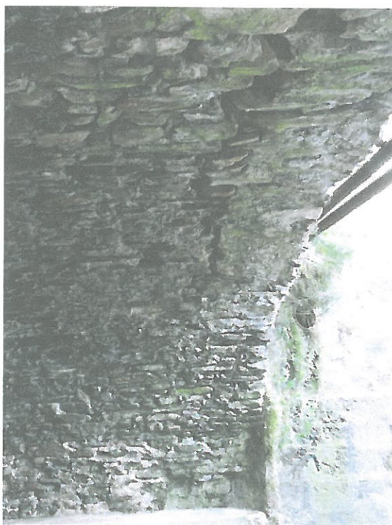
Fot. 10. Pęknięcia, ubytki oraz odspojenie ściany czołowej od strony górnej wody
