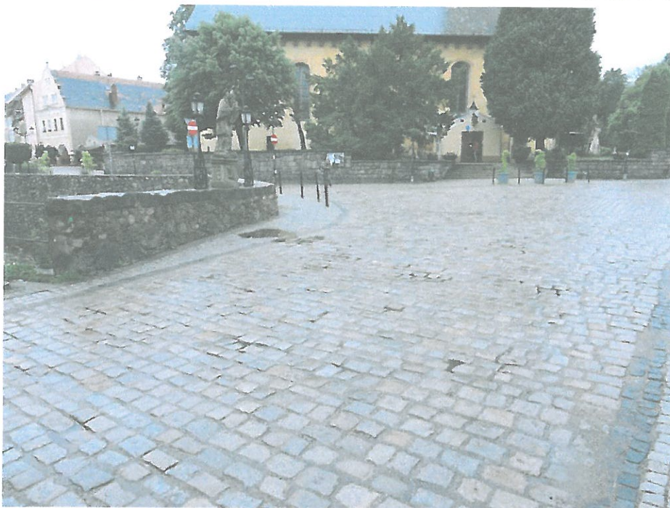
Fot. 1. Lokalne uszkodzenia nawierzchni jezdni na obiekcie
