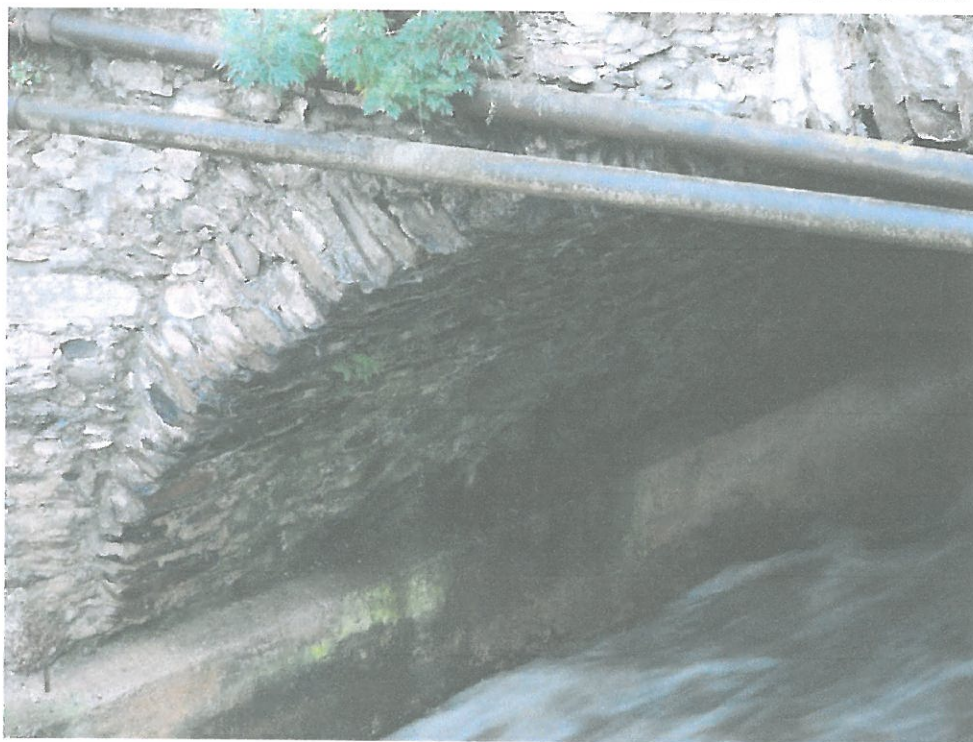
Fot. 5. Zanieczyszczenia i wegetacja elementów betonowych korpusu przyczółka
