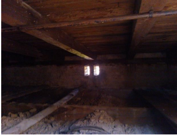
Widok na ścianę kolankową z otworami okiennymi, widoczne krokwie, deskowanie połaci oraz belki konstrukcji dachu .
