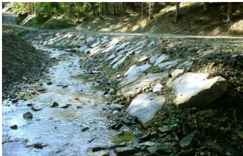
Ryc. 11. Zabezpieczenie brzegów wklęsłych (wg. Dobre praktyki w realizacji obiektów małej retencji w górach. Przeciwdziałanie skutkom odpływu wód opadowych na terenach górskich. Zwiększenie retencji i utrzymanie potoków oraz związanej z nimi infrastruktury w dobrym stanie, 2010.)
