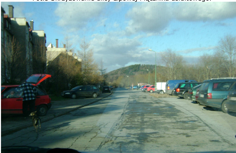
Fot.4 Ulica Lipowa. Widoczne liczne spękania betonowej nawierzchni.
