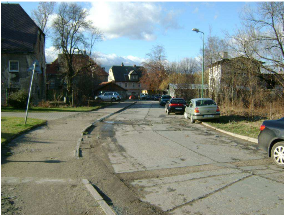
Fot.6 Stan nawierzchni i chodników na ul. Klonowej.
