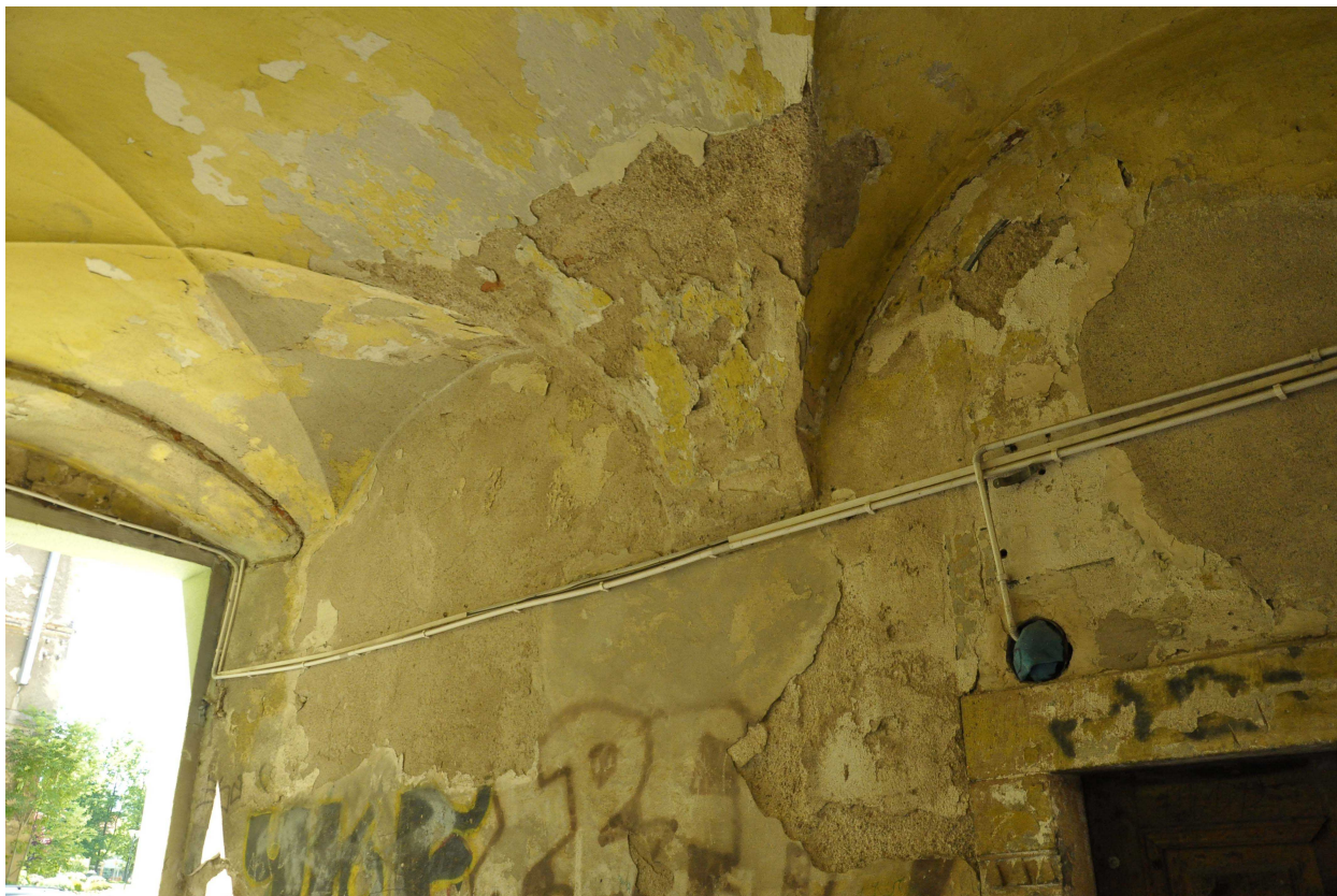
fot. 15. Zniszczenia wilgociowo-solne tynku sklepień u wejścia od strony podwórza
