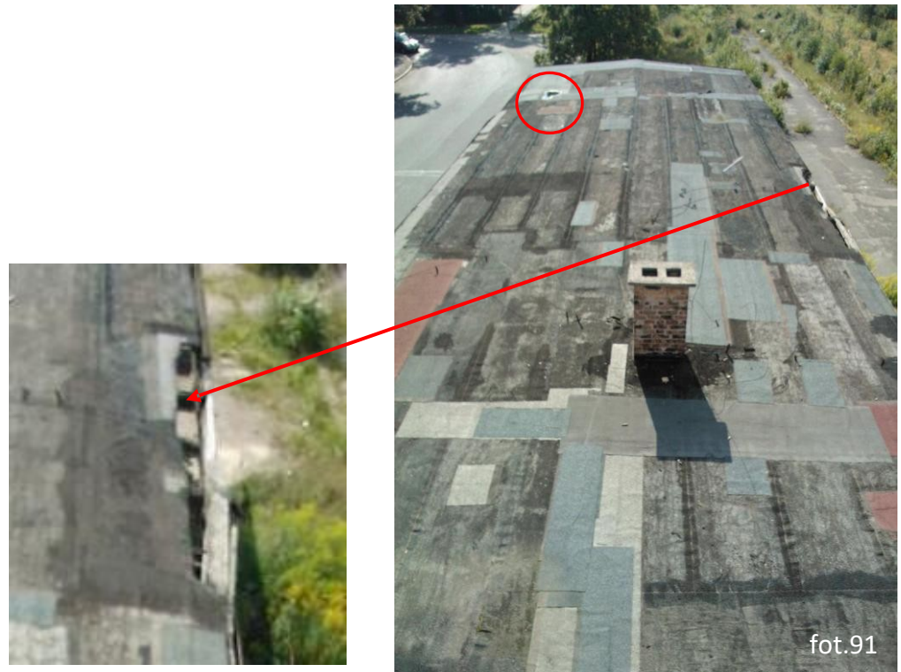
Dach nad magazynem (D). Liczne uszkodzenia pokrycia, obróbek i konstrukcji zadaszona.
