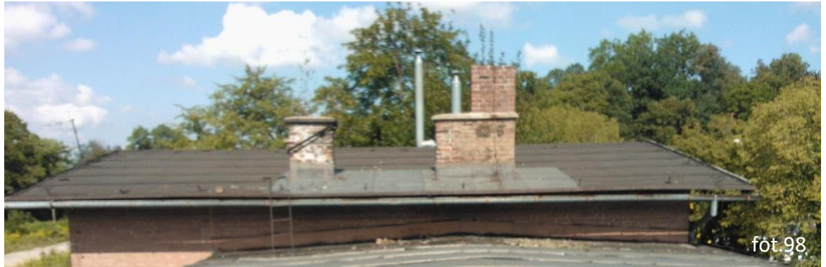
Dach nad segm. A. Uszkodzenia kominów ceglanych, obróbek blacharskich, instalacji deszczowej.
