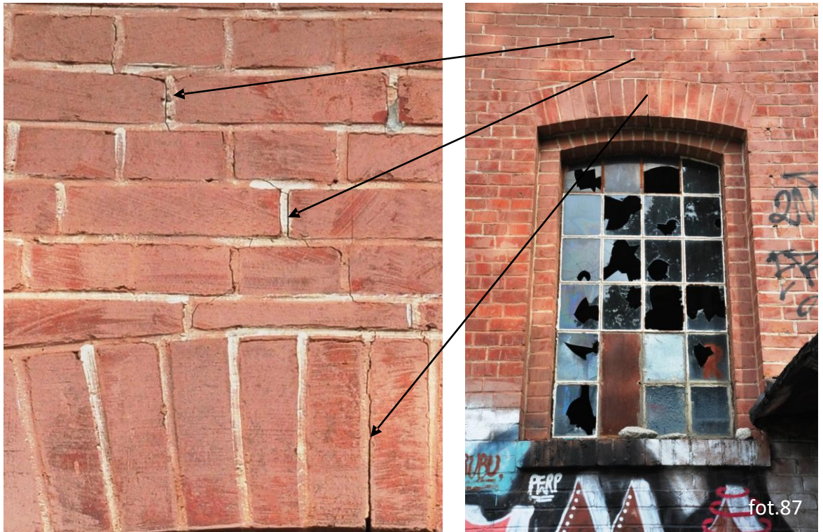
Elewacja pld.wsch. część parterowa. Widoczne pęknięcia ściany zewnętrznej i nadproża ceramicznego w oknie zachodnim.
