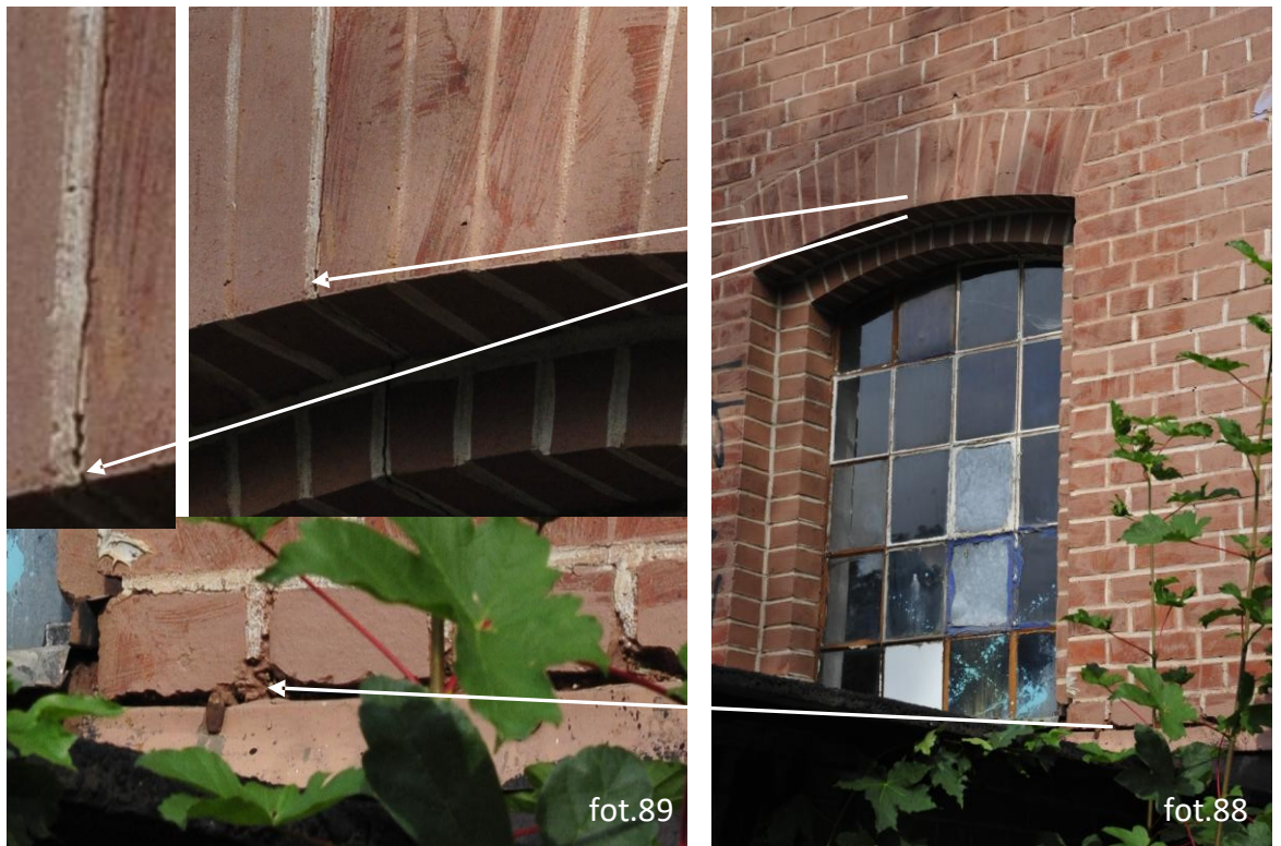
Okno wschodnie: widoczne pęknięcie nadproża ceramicznego i uszkodzenia cegieł i spoiny.
