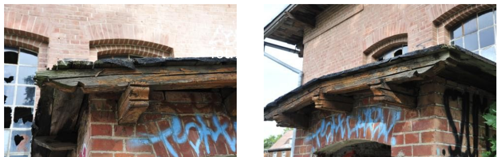
Ganek - detale. Widoczne zniszczenia konstrukcji dachu i porycia
