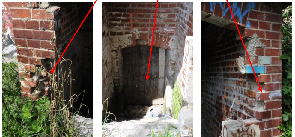
Wejście do piwnicy - ganek. Widoczne liczne uszkodzenia i ubytki muru i cegły.
